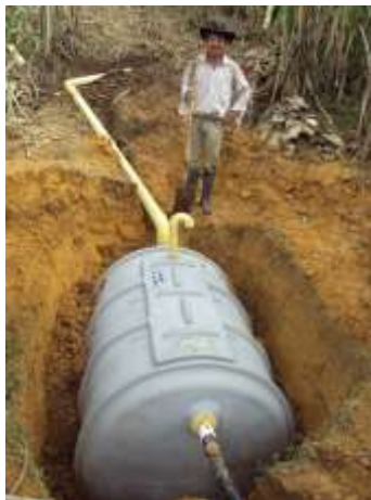
Imagen de Pozo séptico instalado en la vereda La Inmaculada del señor Mario Guarín
